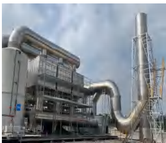
5#暂存库废气处理系统
