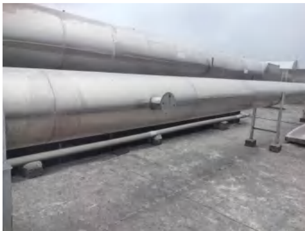
DA006 处理设施 A 进气口采样口
