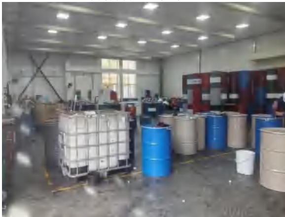
一期物化车间废气收集系统
