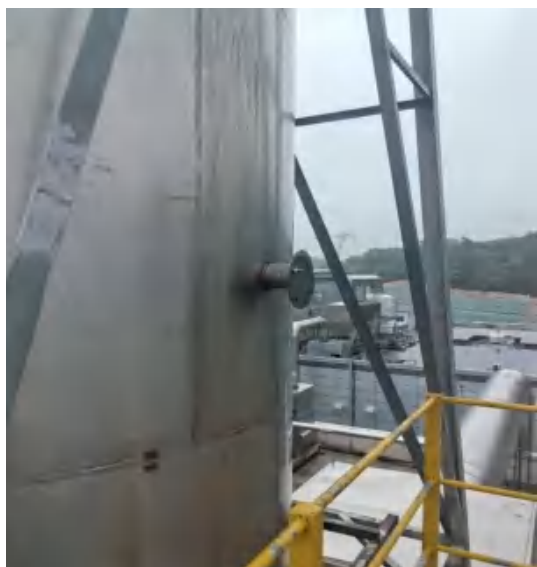
DA007 总排放口采样口
