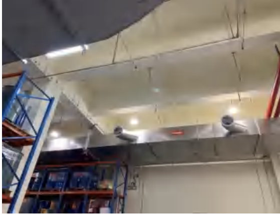
5#暂存库废气收集系统
