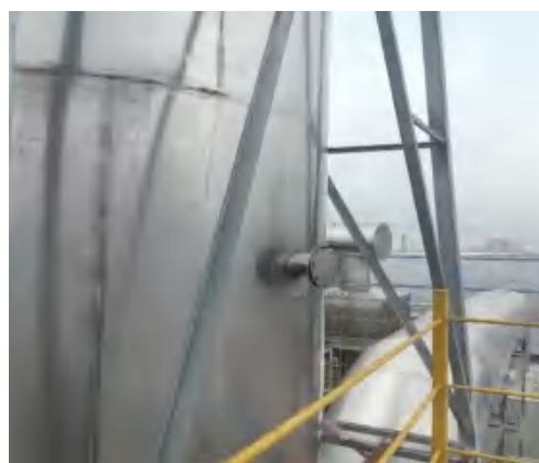
DA006 总排放口采样口
