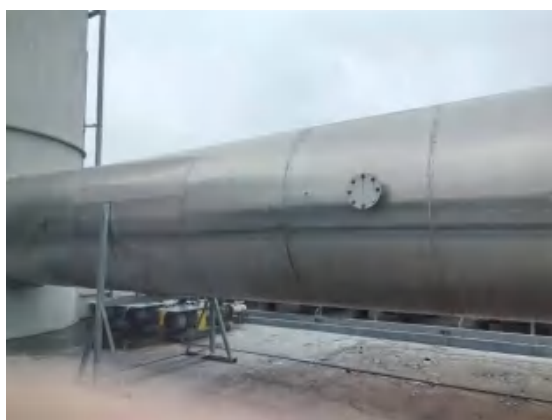
DA006 处理设施 C 进气口采样口
