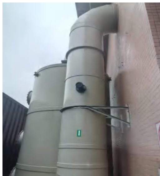
DA012 处理设施进气口采样口
