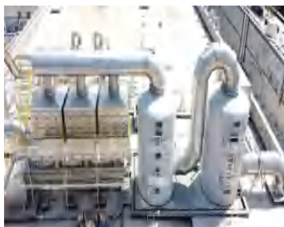
二期物化车间全车间废气处理系统
