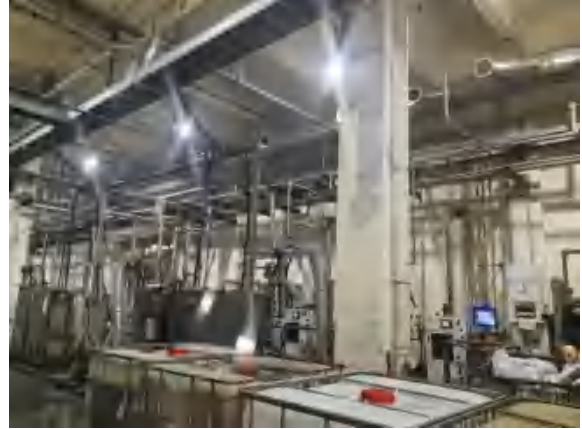
二期物化车间全车间废气收集系统
