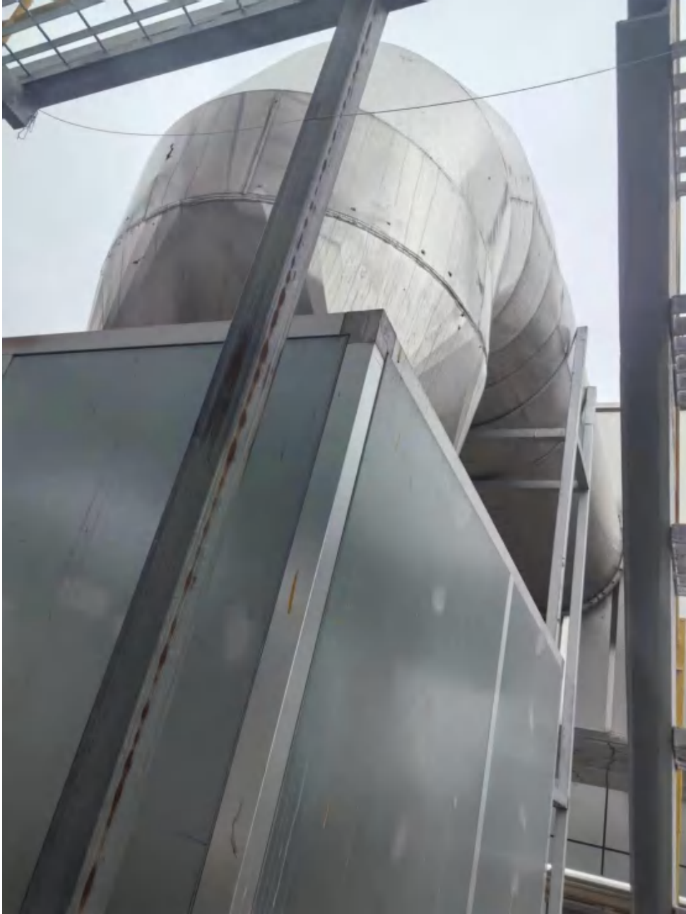
图8.1-1 物化车间废气处理系统排至烟囱段的管道连接
