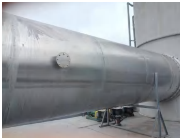
DA006 处理设施 B 进气口采样口
