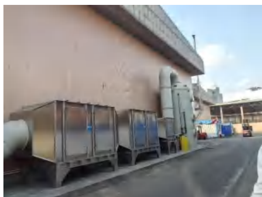
一期物化车间废气处理系统
