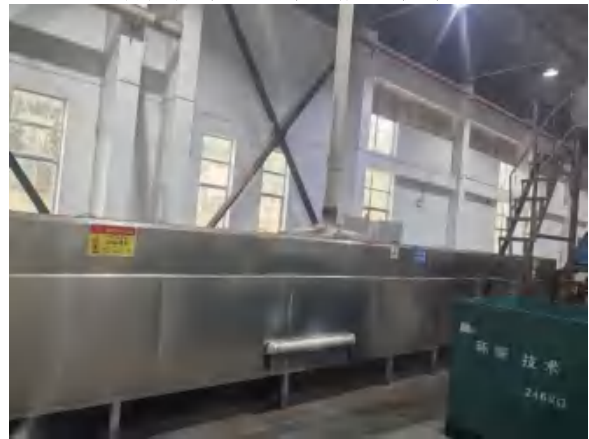
一期物化车间废气收集系统
